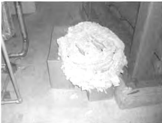
写真1 復旧されず放置された保温材
