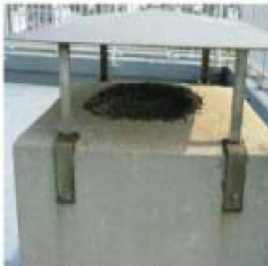
応急処置前の煙突状況
