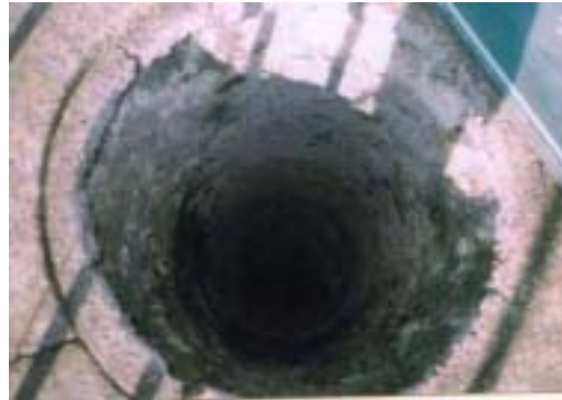
煙突内部石綿
