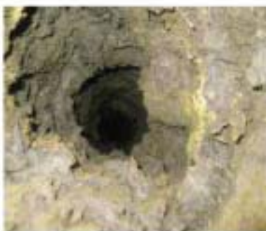
煙突内部のアスベスト断熱材
