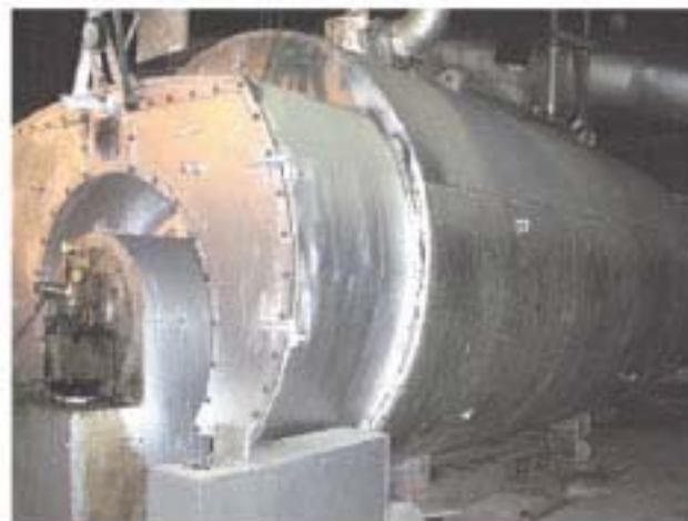
ボイラーの保温材
