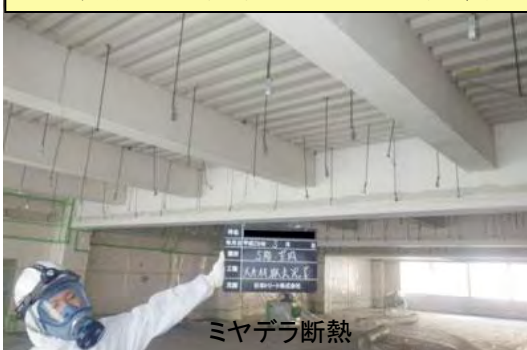
石綿含有耐火被覆板使用の天井裏
